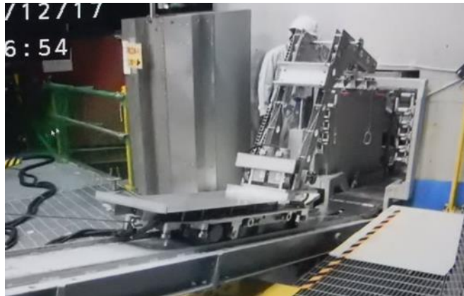
切断片搬出装置 (CRDレール上)
